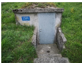
Brunnenstube Katzenrücken, 8905 Arni, Baujahr 1927
